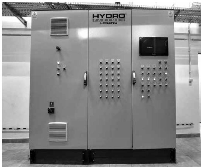
Rozdzielnica Zasilająco – Sterująca – główny „mózg” układu technologicznego
