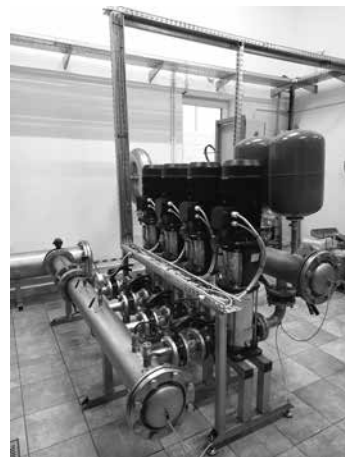
Zestaw pompowy – „serce” układu technologicznego
