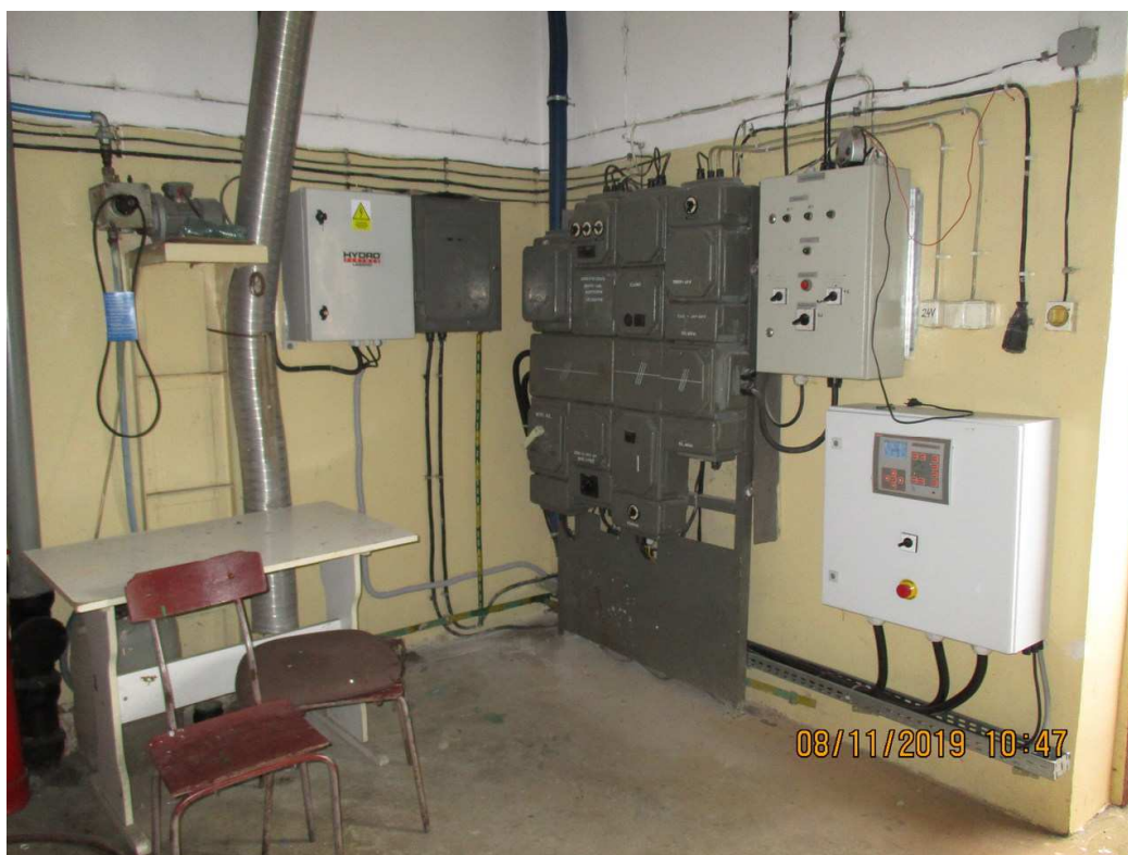
Zdjęcie 12 Budynek Ujęcia Wody – widok na instalacje elektryczne
