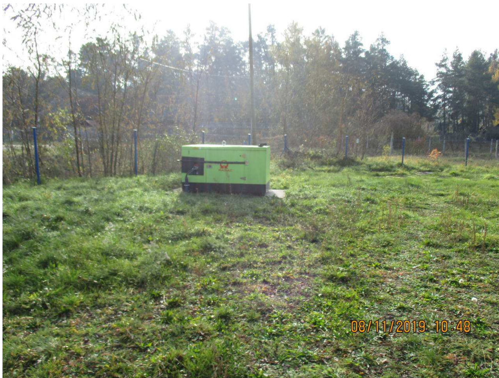
Zdjęcie 3 Zewnętrzny agregat prądowórczy
