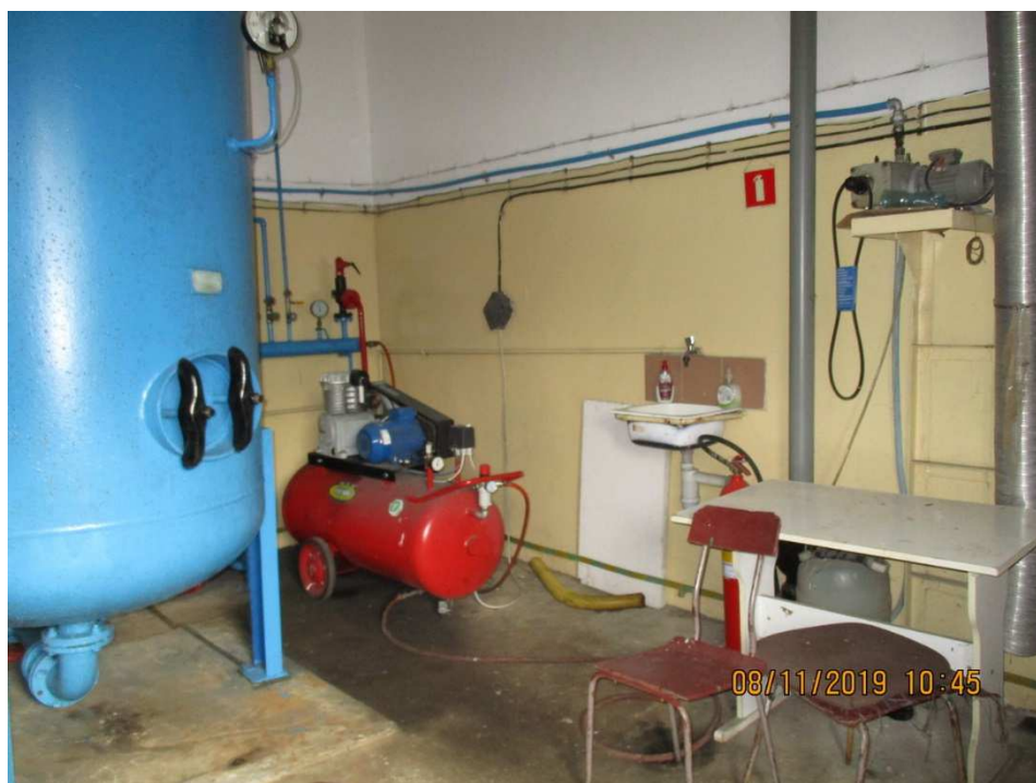
Zdjęcie 10 Budynek Ujęcia Wody – widok na filtr i sprężarkę
