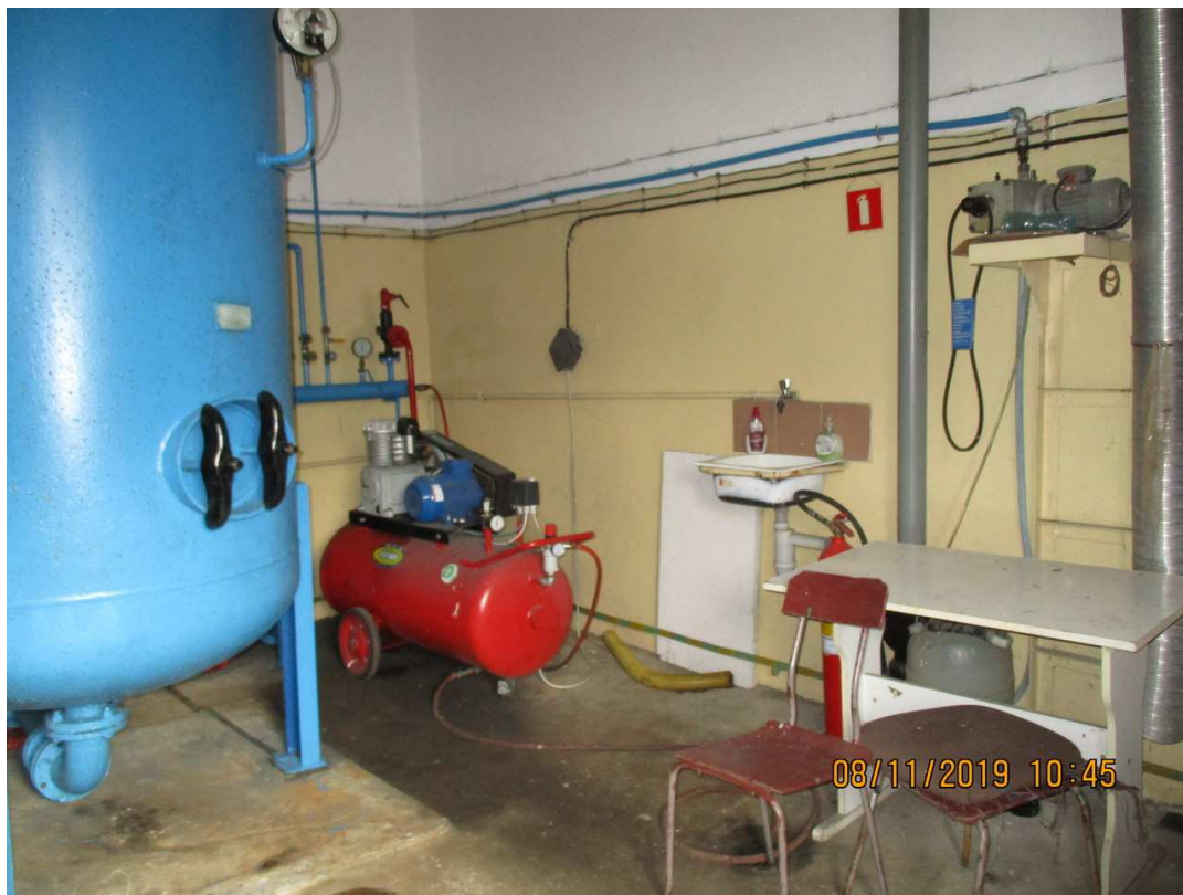
Zdjęcie 13 Budynek Ujęcia Wody – widok na filtr i sprężarkę
