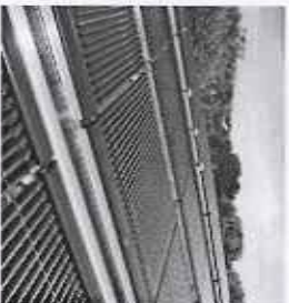
Vitosol 200-T położone bezpośrednio na dachu płaskim.
