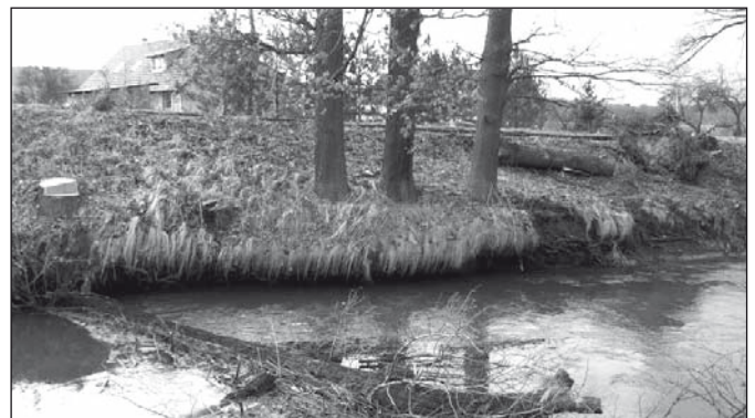
Drzewa z wypłukanymi korzeniami w wale przeciwpowodziowym, dalsze w galerii: http://www.laskiodrzanskie.pl/?strona=galeria&galeria=33
