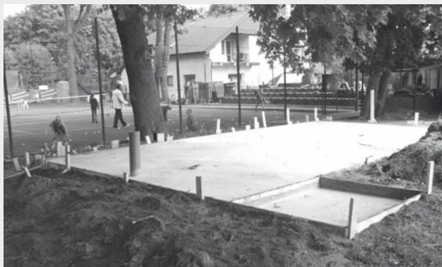
Zanim gazeta dotrze do czytelników w tym miejscu stanie nowy obiekt z szatnią i węzłem sanitarnym
